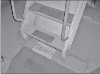
ステップには警戒塗装と滑り止め
